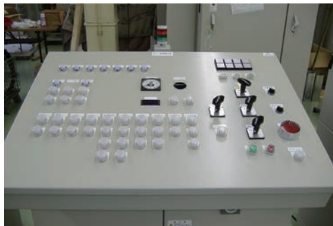
スカーリフト運転操作盤(デスクタイプ)
